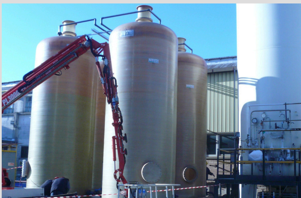
BATTERIA DI SERBATOI DA 35MC DN 2500
