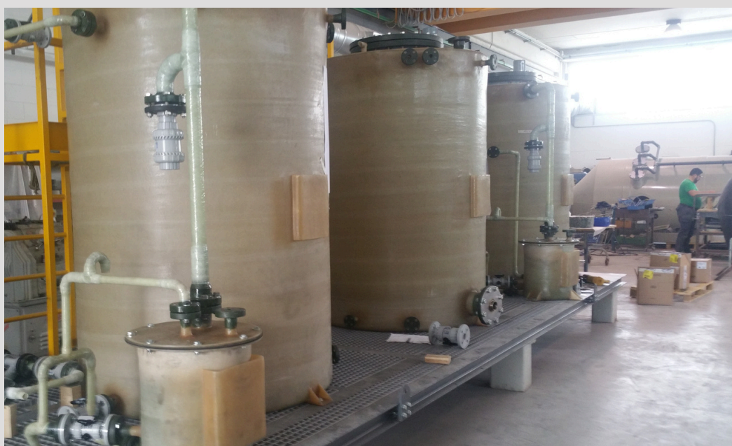
SKID DI SERBATOI ART.4 E ART.1
